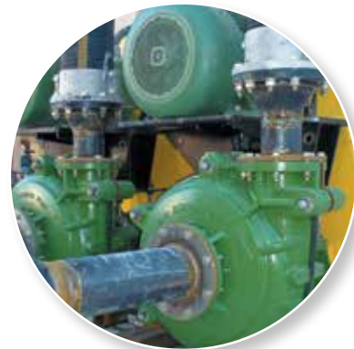
Bombas Schurco 8x6 Serie S en un productor de arena industrial
